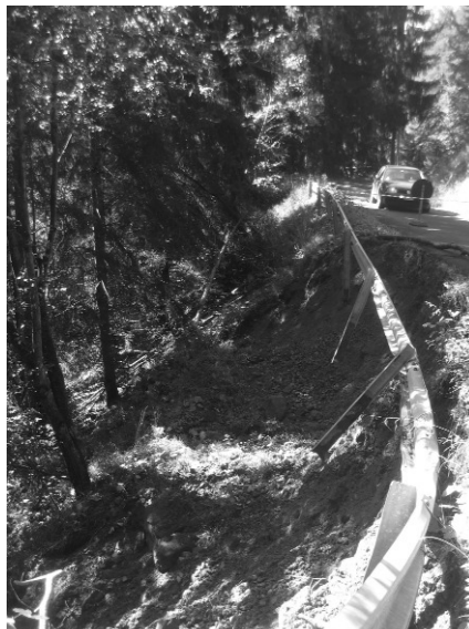
Viele Straßen wurden heuer aufgrund der Witterung stark in Mitleidenschaft gezogen.
